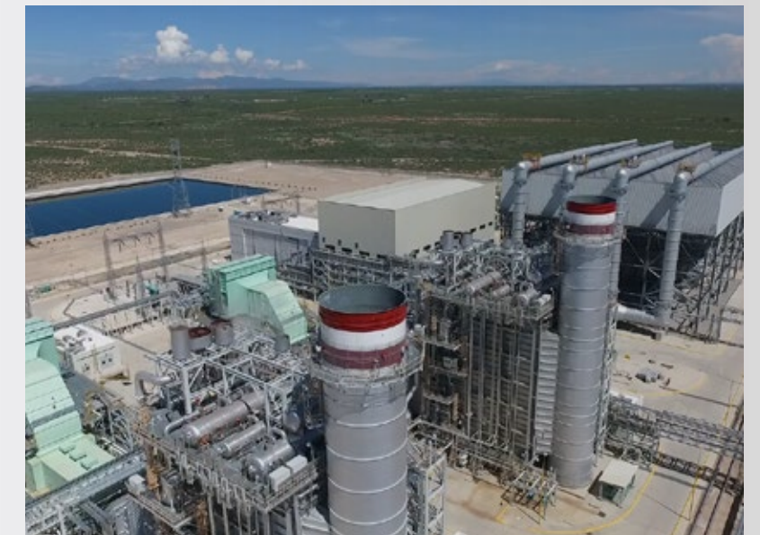
Central Ciclo Combinado Agua Prieta II. Diciembre 2016.
